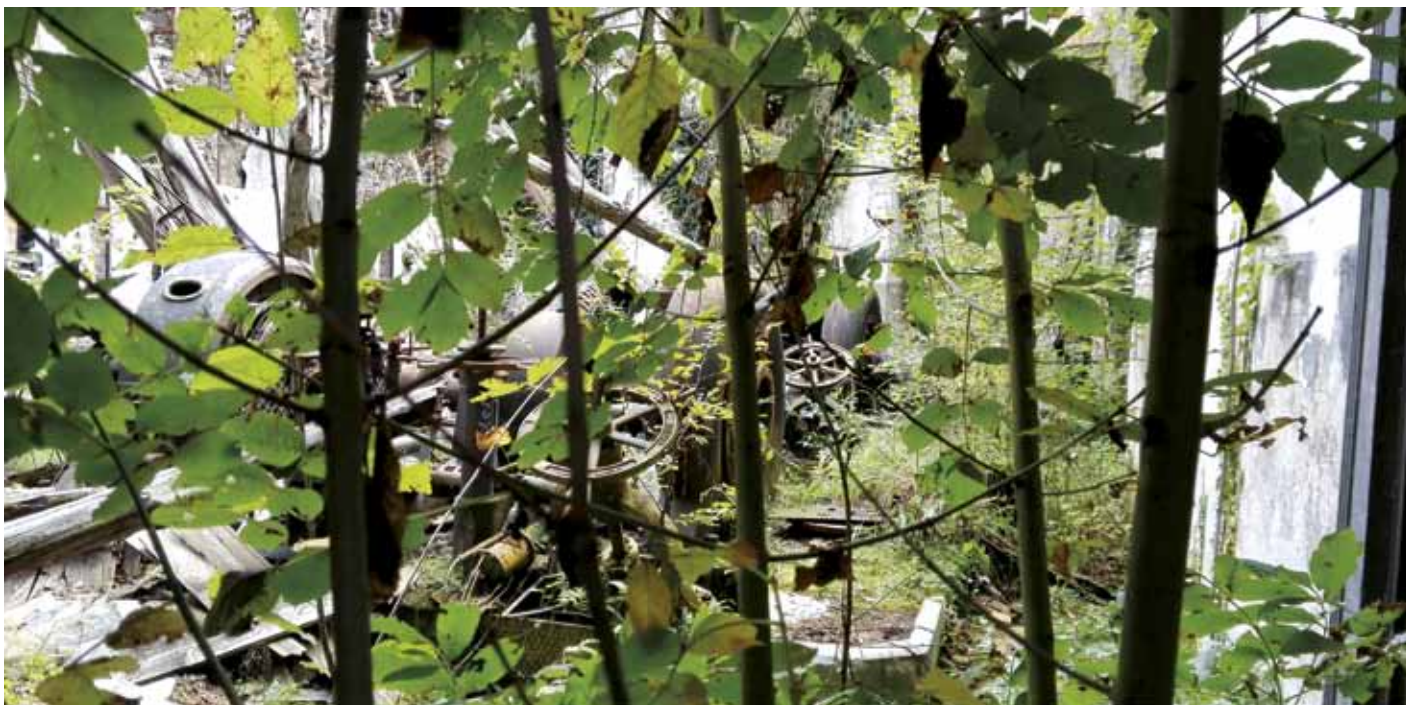
La centralina idroelettrica lungo l'Ardo e la sala macchine (foto M. Azzalini).
